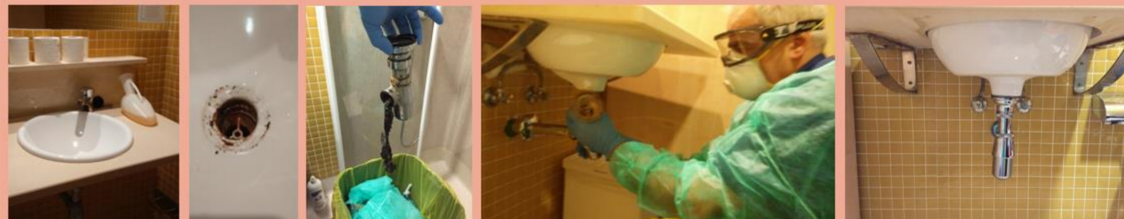
Imágenes 1: Lavabo afectado, estado rejilla y sifón, recambio de sifón y resultado final
